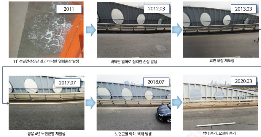
[그림 3-16] 교면포장 조기 파손 사례(성산대교)
