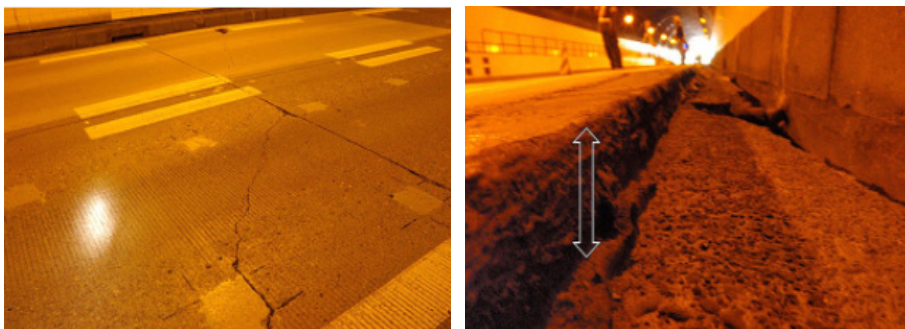
(a) 노면 용기에 의한 균열
