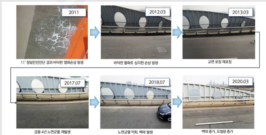
【그림 1】 바닥판 열화로 인한 교면포장 조기파손 사례(성산대교)
